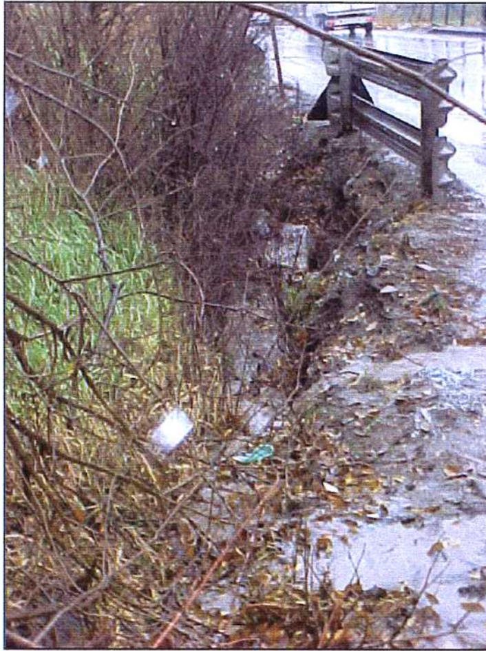
Fig. 5 - Insedimento di Pratolungo: parte nord dell'area. Problematiche di deflusso e drenaggio idrico di una sede stradale a servizio dell'insediamento.
